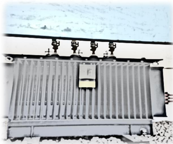
Foto 1: Imagen de un transformador eléctrico.
